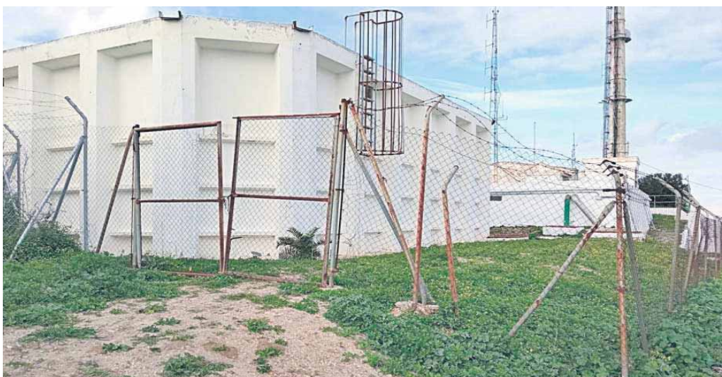
El casco urbano de la población vejeriega se abastece de los depósitos situados en la zona conocida como El Santo.
